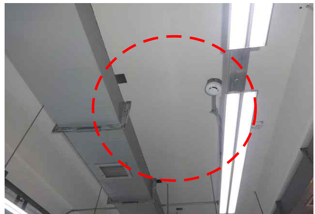
내부 천정, 마감 망상균열 (A=5.0m×1.0m)
