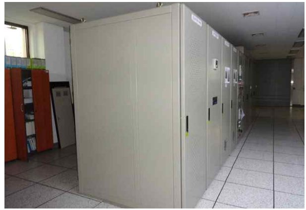
내부 수배전실 전경
