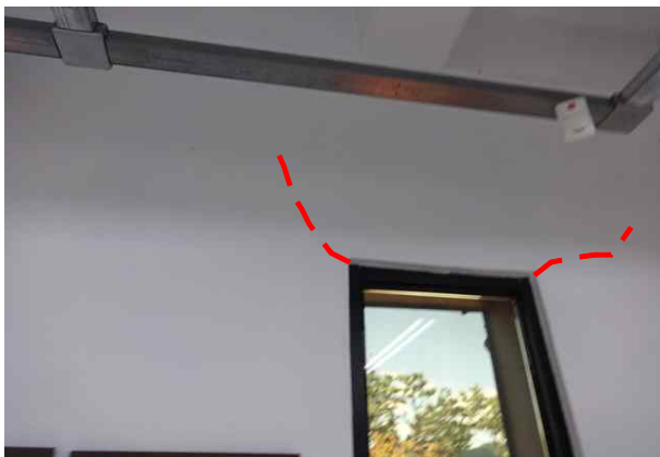
내부 벽체, 마감 균열 (CW=0.2mm, L=1.0m, 2EA)
