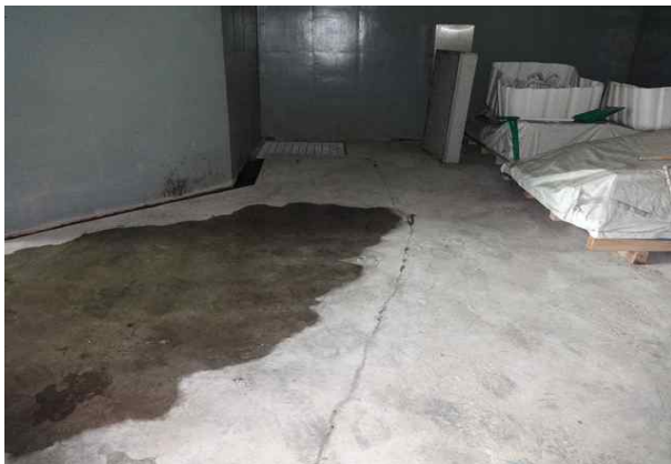
내부 바닥 마감 균열 (CW=1.0mm, L=0.8m)
