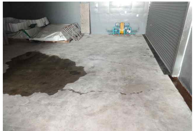
내부 바닥 마감 균열 (CW=0.2mm, L=5.0m)
